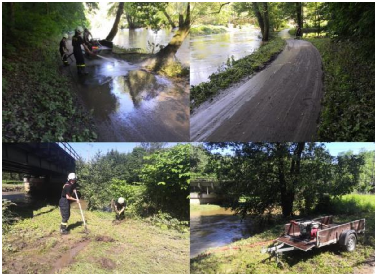
Obr. 22 Odklizení škod po povodních v červnu 2020
